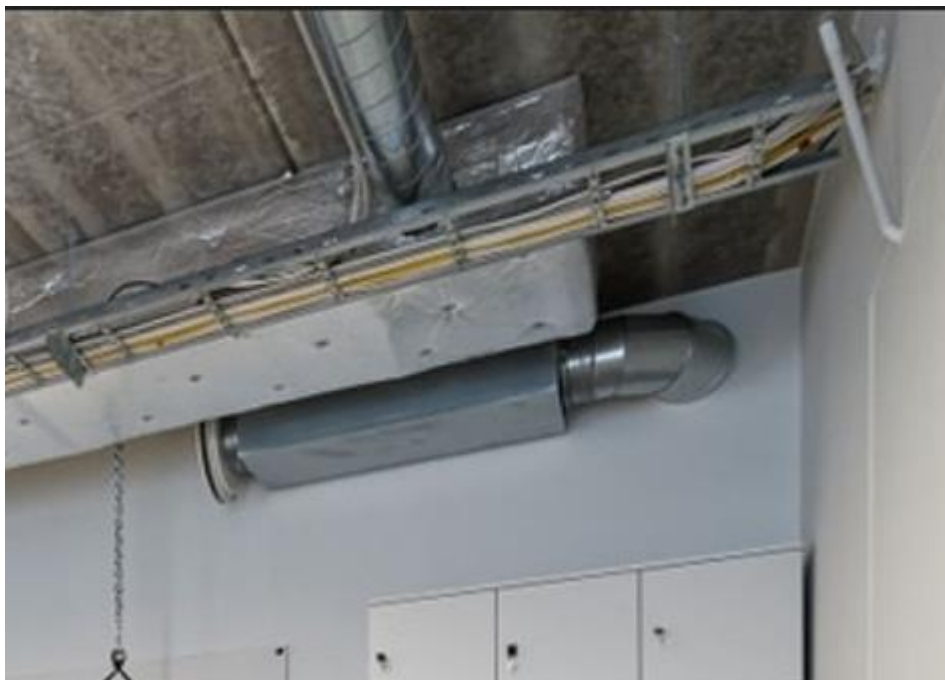
Figura 8 - Canale di trasferimento aria con silenziatore e bocchetta per il transito dell'aria primaria dai locali verso i corridoi e le parti comuni
